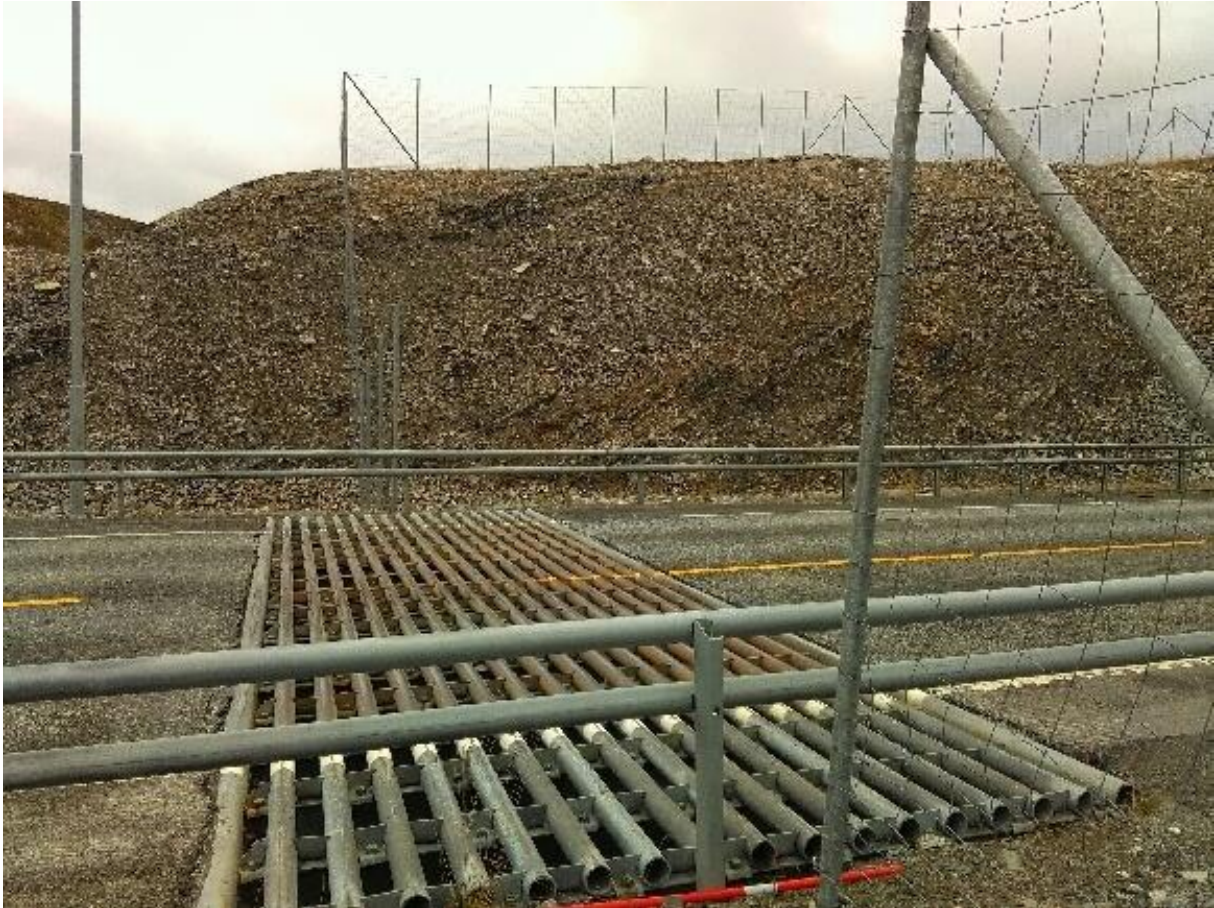
Figur 28. Ferist og sikringsgjerde riksveg 64. Detalj. Foto: Aslak Ante M Sara
