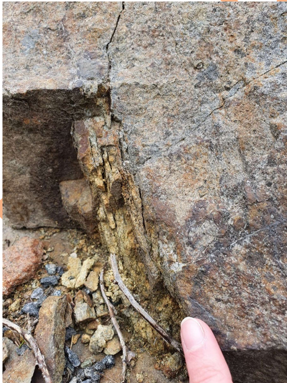
Figur 6-20: Forvitring i båndgneis fra befaringslokalitet C006.
