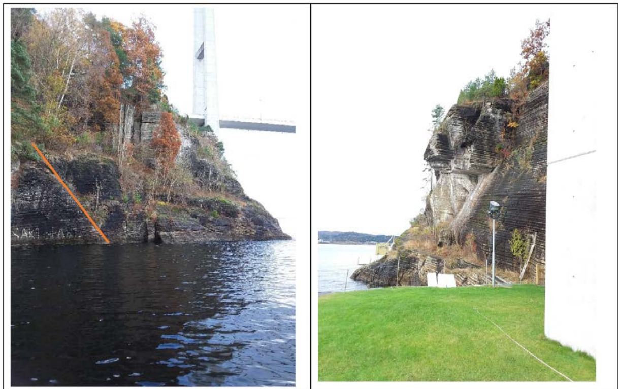
Figur 5-8 Foto som viser overheng og sprekkdannelser ved nordre brufundament.
