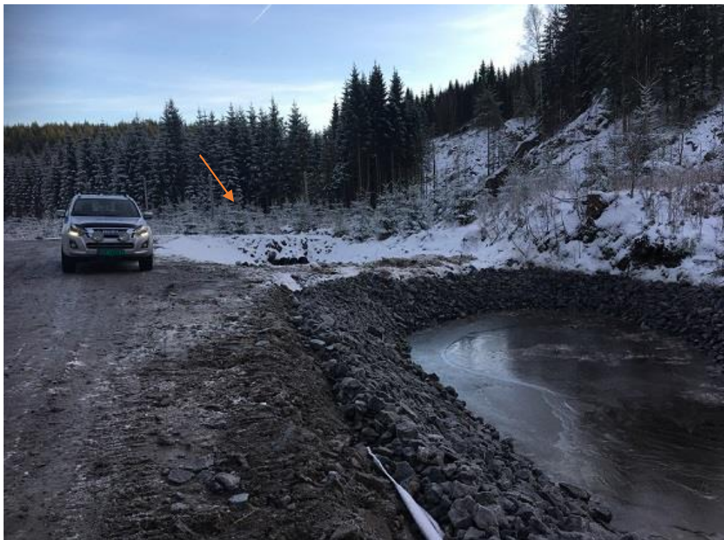
Figur 8-4. Rensedammer Svartholt. Pil viser overløp i nederste dam
