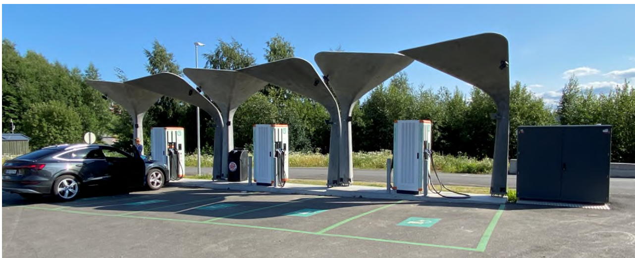
Figur 7-2: Eksempel på ladestasjon med seks lynladere (150 kW) langs E6 ved Lillehammer som driftes av Grønn kontakt.
