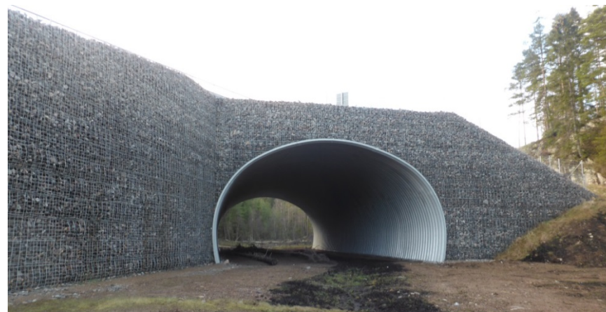
Eksempel på undergang for vilt utført som gabionmur under vei 27 ved Borås i Sverige. Foto: Henrik Undeland
